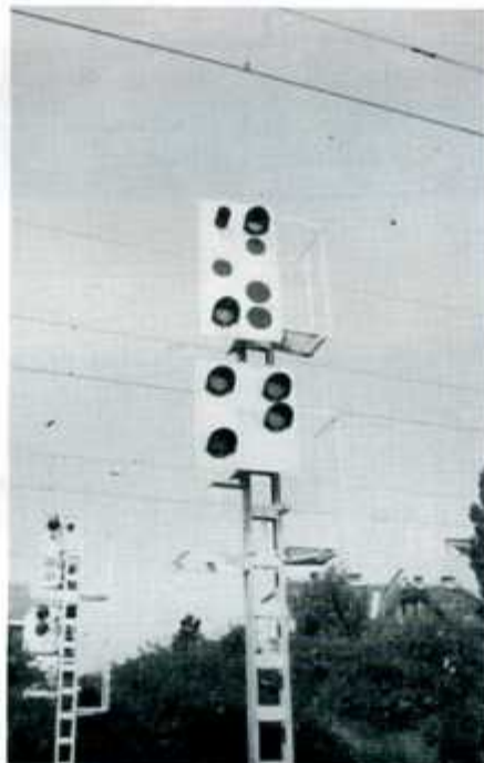
Bild 1 (und Titelbild): Im Bahnhof Liesing neu aufgestellte, noch nicht in Betrieb genommene Hauptsignale.
